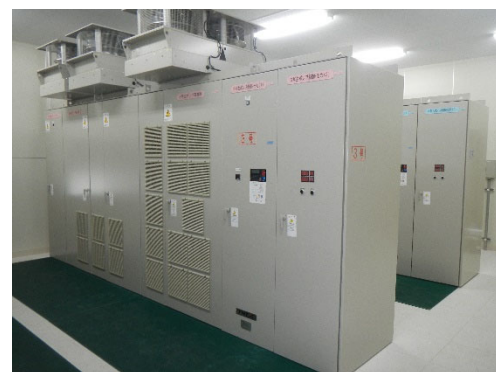
図2. インバータ制御装置
