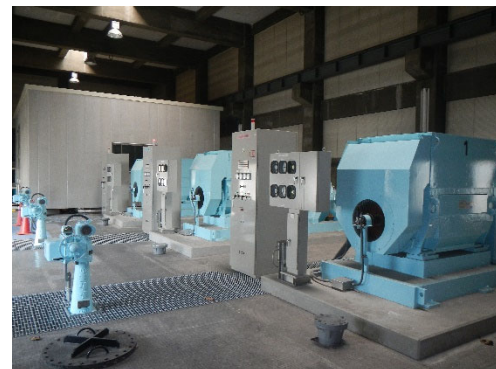
図1. 高効率上水道ポンプ
